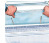
Folie hinter dem Heizkörper platzieren
